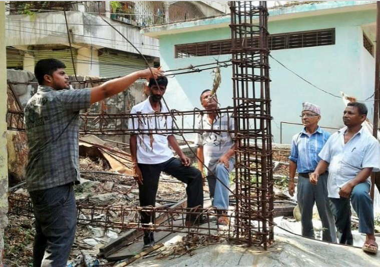
घरधनी र ठेकेदारलाई पिलरवाला निर्माण प्रक्रियाबारे बुझाउन नगरपालिकाको प्रांगणमा रहेको नमुना देखाउँदै सुयोग गिरी
